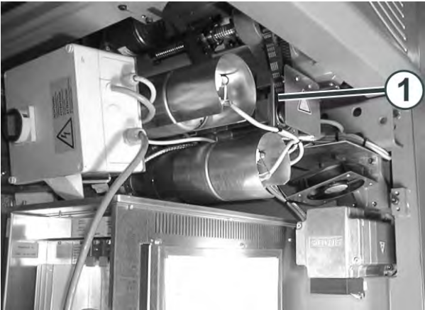
Motor del variador
