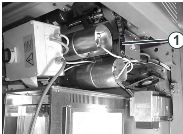
Motor del variador
