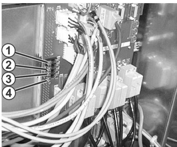
Fusibili sul lato posteriore dell'apparecchio di comando sinistro
