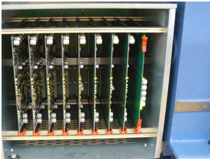
Шкаф управления слева
