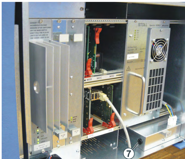
Batteriesicherung unterhalb des Netzgerätes
