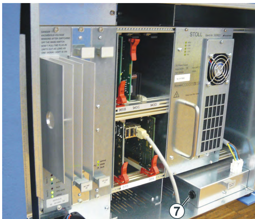
Fusibile della batteria sotto l'alimentatore
